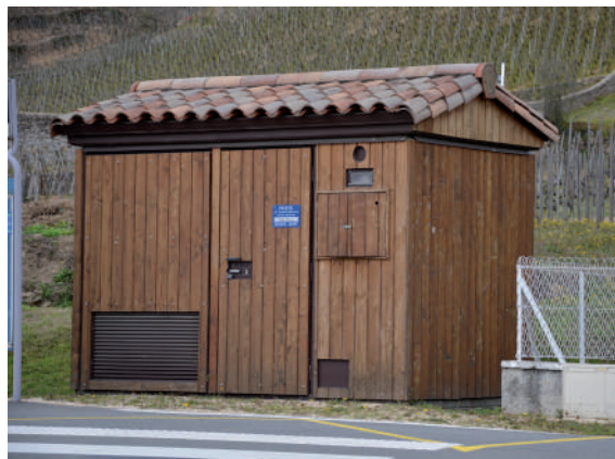
Exemple de traitement d'un transformateur électrique à privilégier
